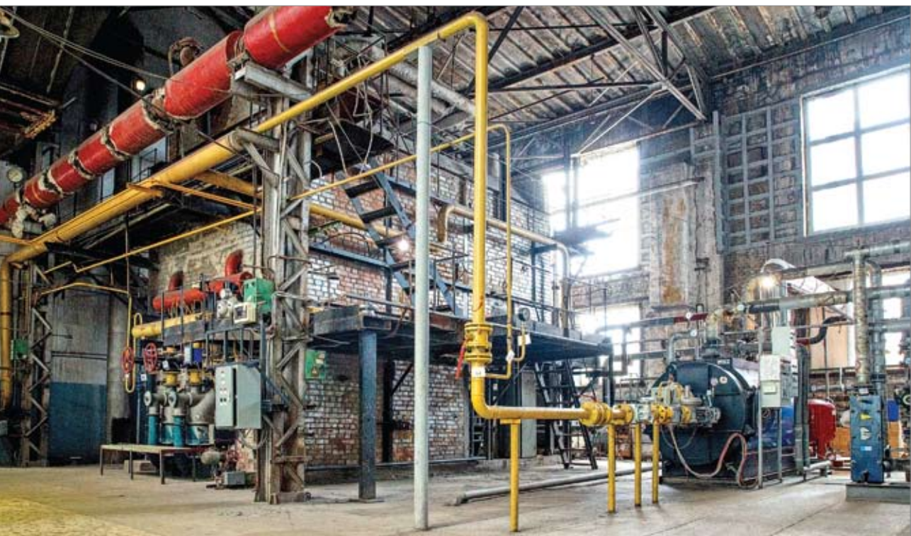
Котельная Центра культуры и бизнеса «Москва-Сокол».
