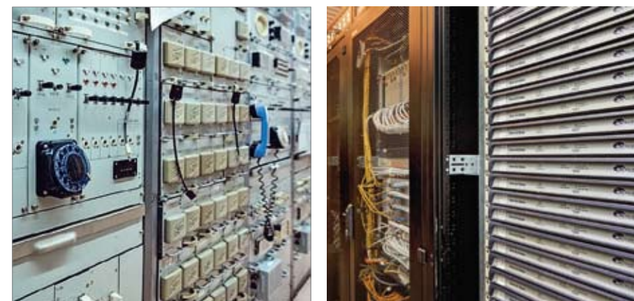
Так выглядела аппаратная аналогового телефонного узла в 1990-е – слева. А справа – часть цифровой АТС – коммутаторы для подключения телефонного оборудования пользователей в Центре обработки данных «Социум-Телеком», наши дни.
